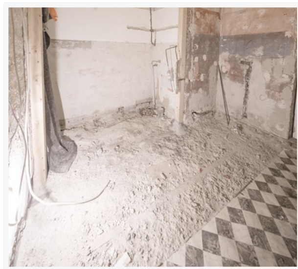
Exemple pratique : Sol irrégulier après retrait du carrelage.
