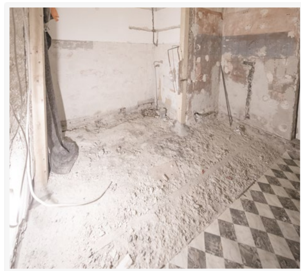
Aus der Praxis: Unebener Boden nach Entfernung der Fliesen.
